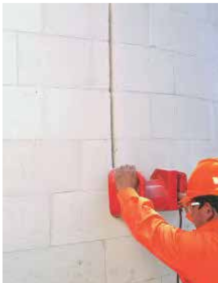
Fig. 25: Ranurador eléctrico Macroza.
