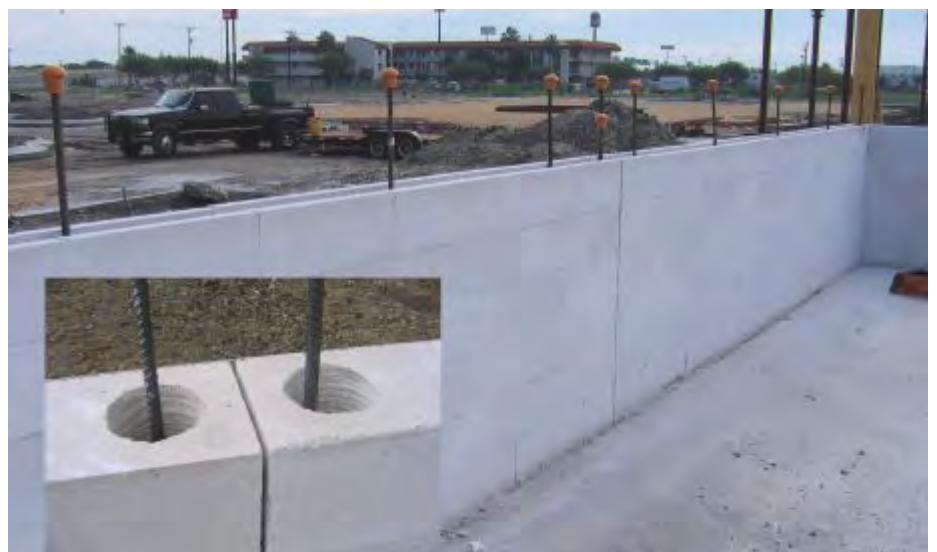
Fig. 17: Junta de control en muro.
