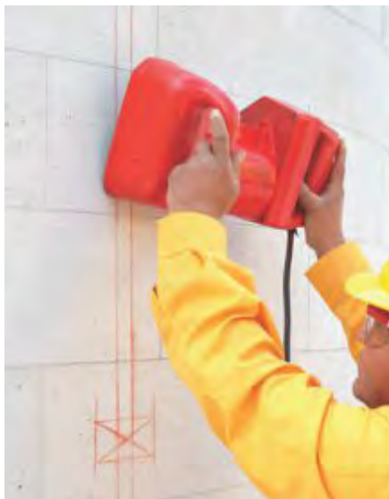
Fig. 16: Ranurador eléctrico Macroza.
